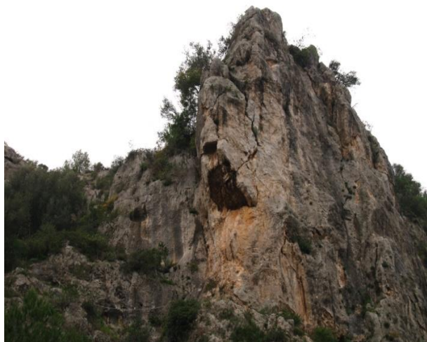
Fig. 4 - Sinistra. Esempio di possibile crollo (foto Gentile G.C.)
