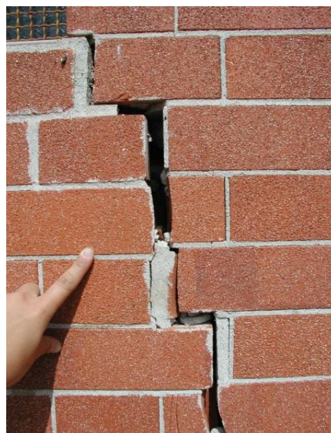
Fig. 2 - Lesioni dell'edificio adiacente al sito d'innescò della voragine apertasi nella primavera del 2010.
